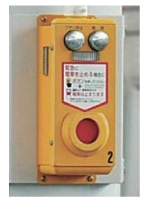
駅非常停止ボタン
