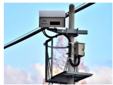
踏切障害物検知装置
